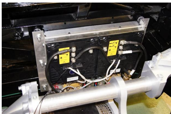
fig.6 : Variateurs montés sur le châssis
